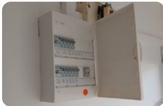
Nouveau tableau électrique
